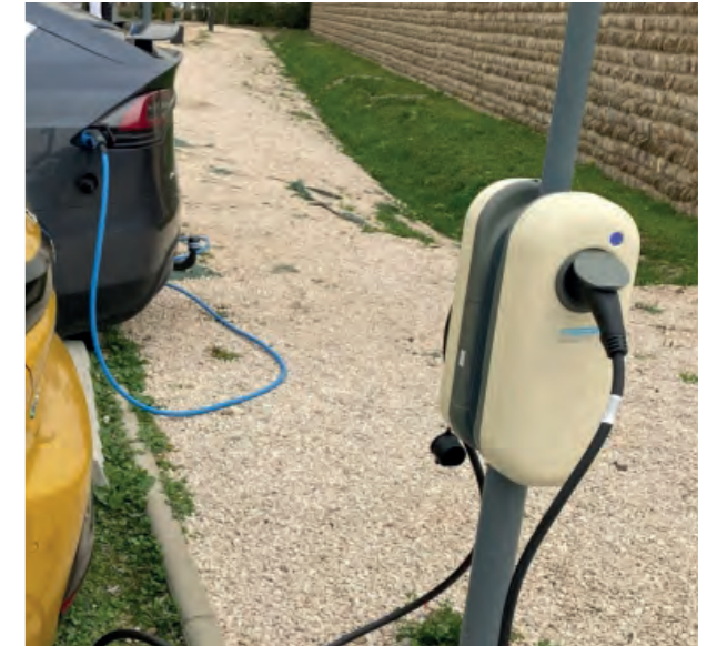
Des prises pour voitures électriques discrètes (ci-dessous espace public, Miramas)
