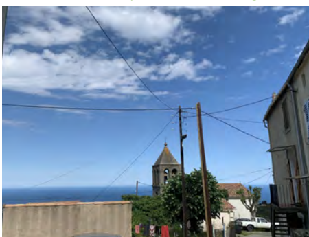
Les poteaux électriques
